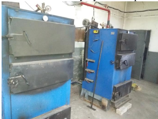
Фото 1 встановлені котли «Еталон» КСТО-98.
