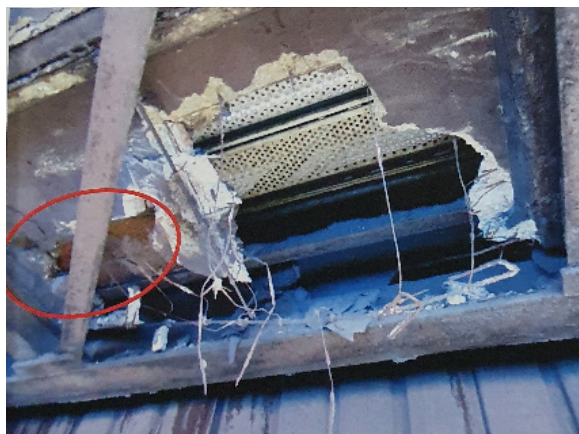
Foto 4. Detaliu perimetru care a cedat la data producerii evenimentului
