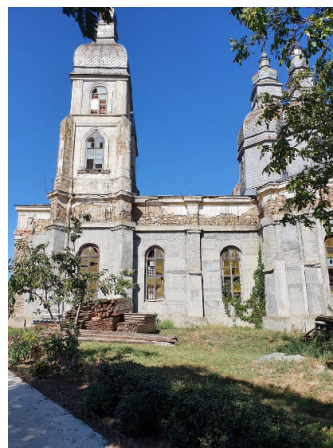
Foto 10. Intervenție total neadecvată
