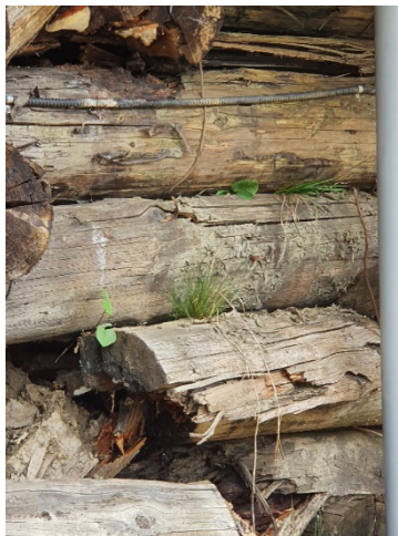
Foto 11. Mișcarea elementelor din lemn orizontale prin cedarea terenului.
