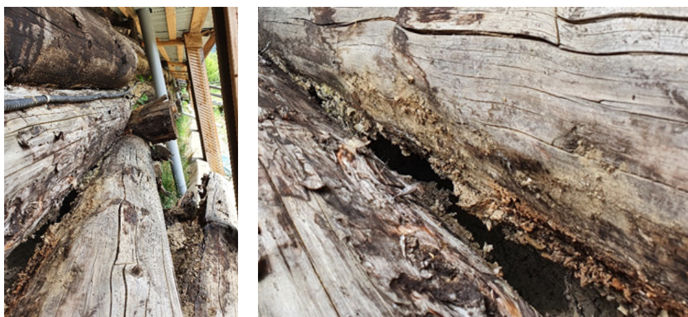
Foto 3-4. Goluri vizibile în structura căsoaiei.
