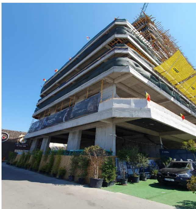
Foto 8. Depășirea regimului de înălțime față de Autorizația de construire emisă.
