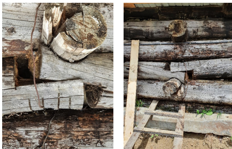
Foto 5-6. Imagine perete exterior al căsoaiei către parcare. Se observă zone excesiv de putrede și deplasarea buștenilor orizontali, din alunecare teren, cu afectarea zonelor de îmbinare. De asemenea, degradarea lemnului din atac biologic.
